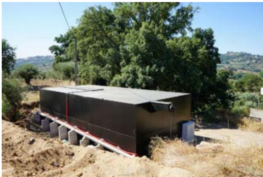
Imagem 85 – ETAR - Estação de tratamento de águas residuais
